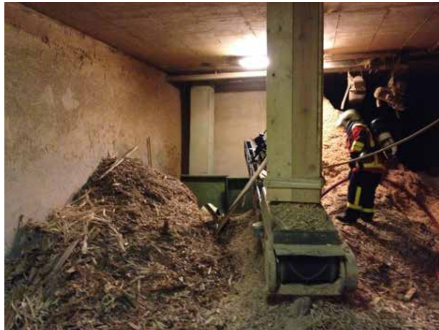
Schnitzelbunker oberhalb Heizanlage
